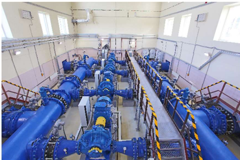
Водоканал г. Санкт-Петербурга Насосная станция Таллинская
