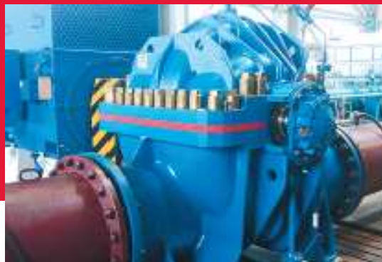
Южная водопроводная станция
