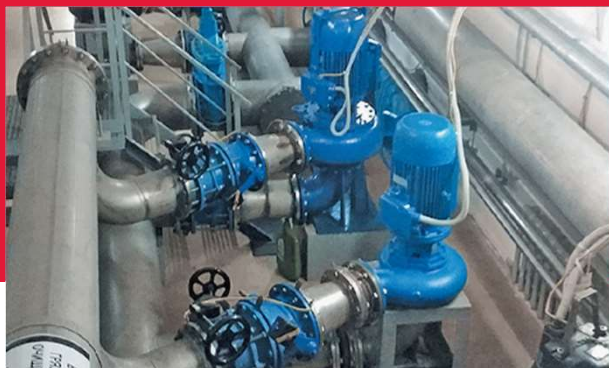
Водоканал г. Санкт-Петербург
