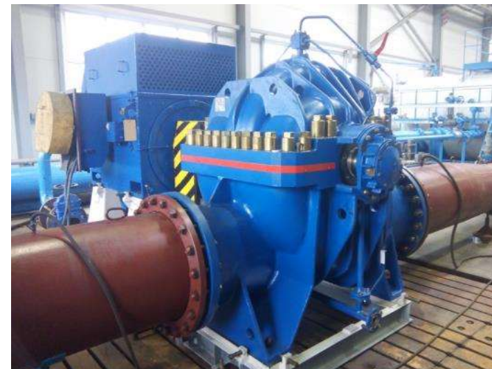
Водоканал г. Санкт-Петербурга Насосная станция Южная
